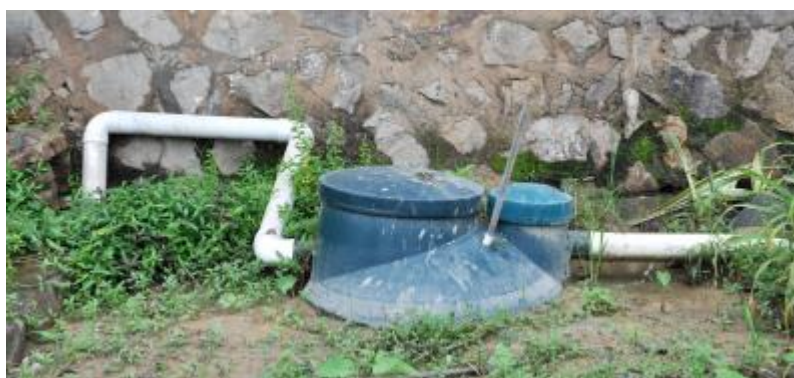
图4 污水处理设施
